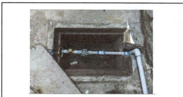
Foto 4: Sustracción de caja de contador.
