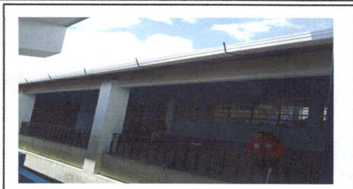
Foto 2: Sustracción de canales PVC.
